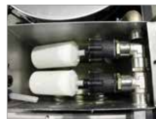
INNEBYGGET VANNKASSE MED DOBBEL FLOTTØR SIKRING.
