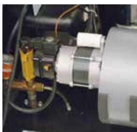
En-faset motor koblet til vifte og dieselpumpe
